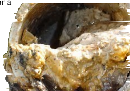
Rør som har blitt tett av fett.
