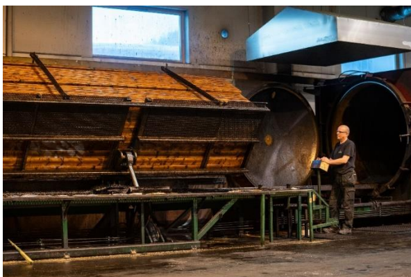
Figur 6. Autoklaver for royalbehandling i bygg 111. Bygget inneholder to identiske autoklaver.
